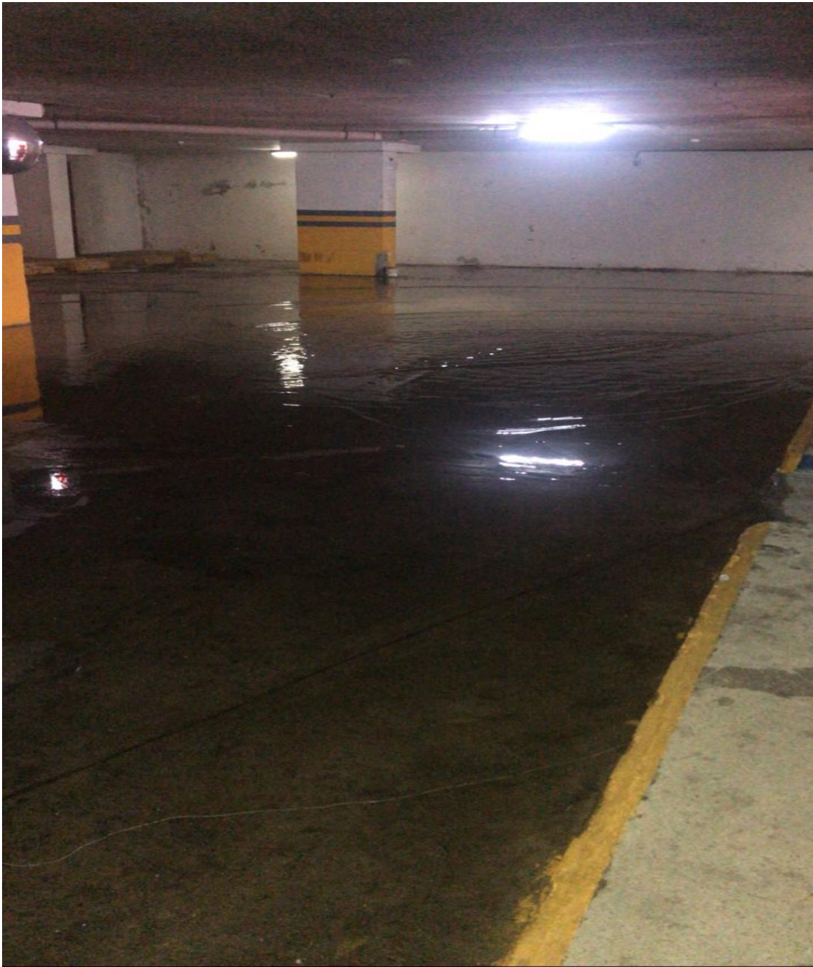
OBSTRUCCION DE CAÑERIAS EN ESTACIONAMIENTO DE VISITAS
