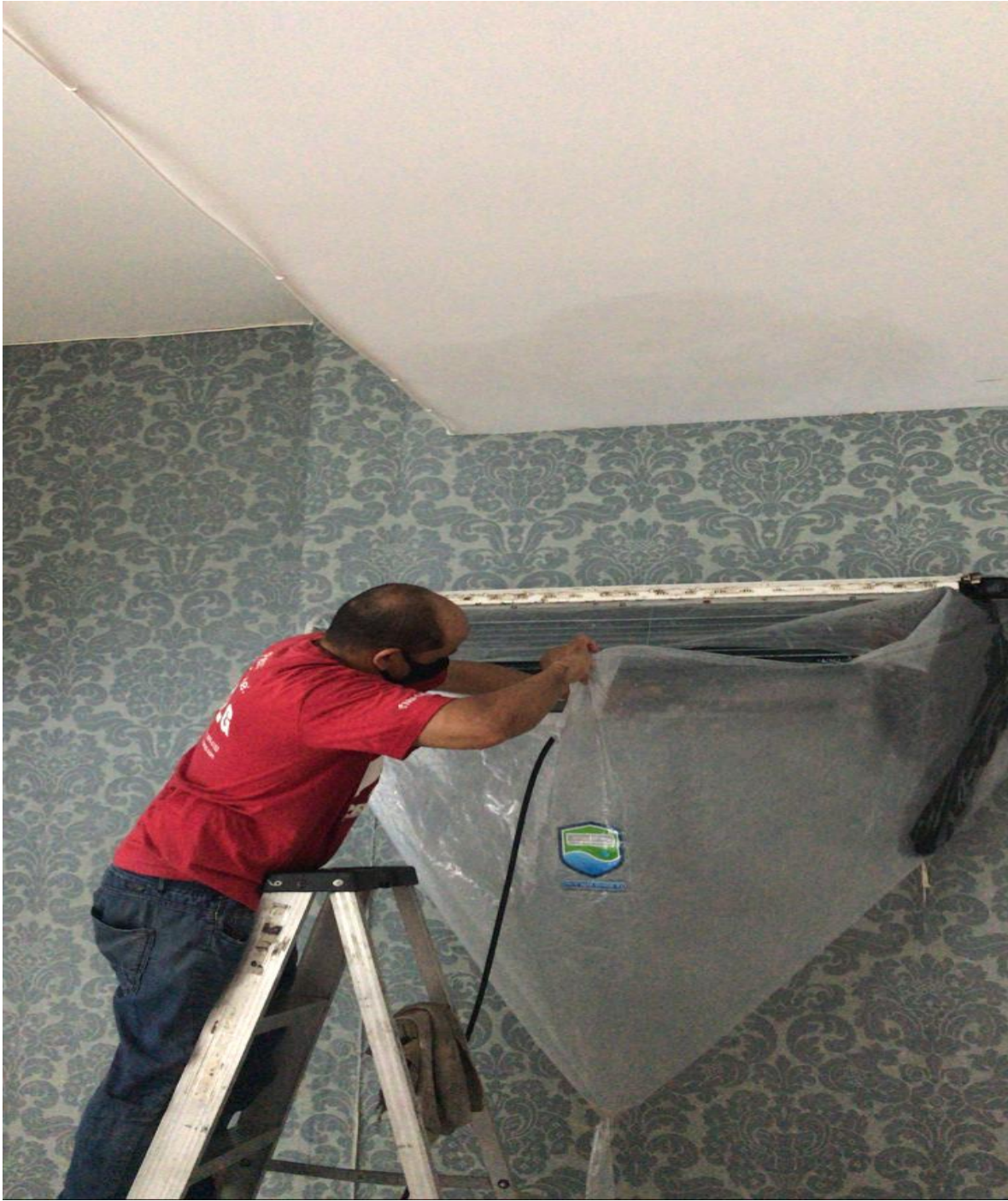
MANTENIMIENTO DE AIRES ACONDICIONADOS
