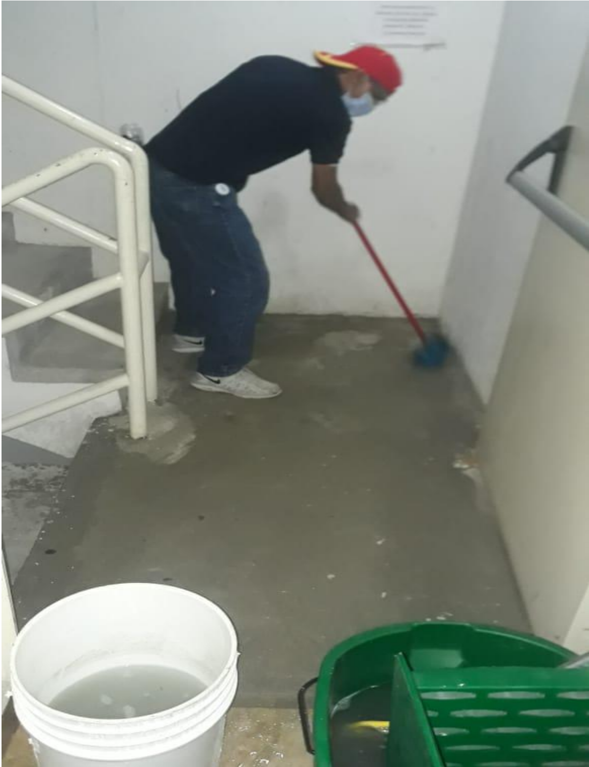
Lavado e todos los pisos donde reposan los tinacos
