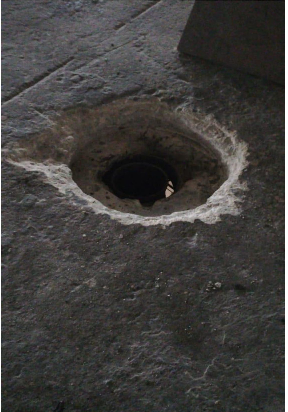
CAMBIO DE DESAGUE AFECTADO ESTACIONAMIENTOS
