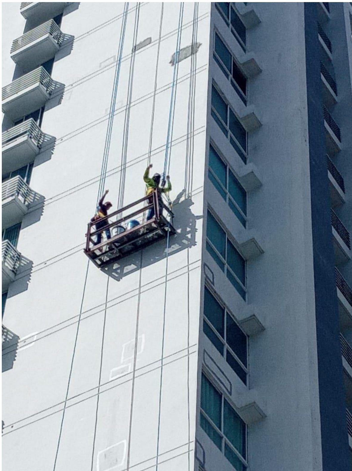
REPARACION DE REPELLOS FLOJOS TRANSMISORES DE AGUA DE LLUVIA HACIA EL INTERIOR DE LOS APARTAMENTOS
